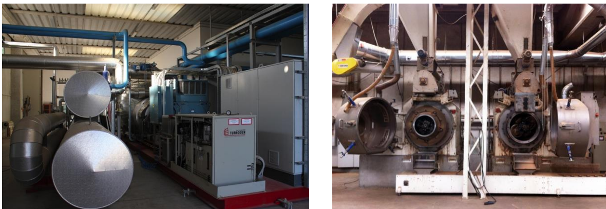
Bild 3 – a) KWK-Anlage für die Erzeugung von Strom / Wärmeenergie (1 MWe) [AdriaWatt, 2014]; b) Industrielle Pellettieranlage [Friul Energie, 2014].
